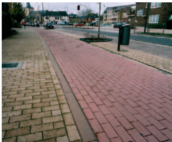
Les éléments de contrebutage servent également de caniveau. Pavage avec joints continus dans le sens longitudinal.
